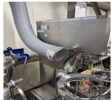
集塵機による粉塵対策
