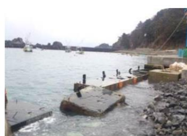
被災した現場（宮城県）
