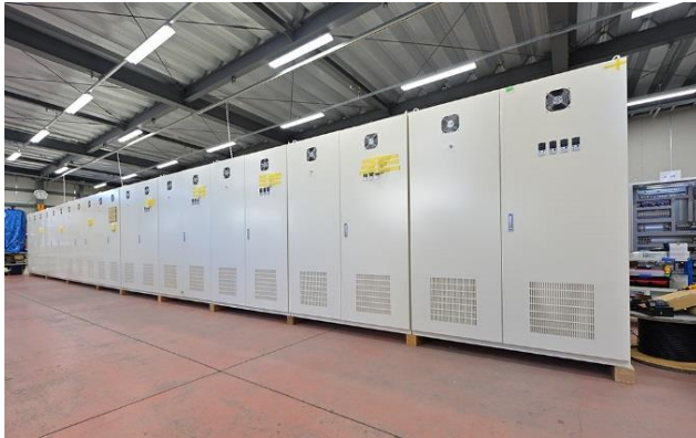
大型制御盤の例（※写真のもの全体で1台）
