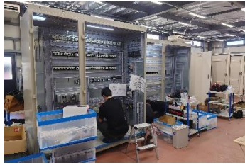
大型制御盤の製造 (奥側は男女ペアでの作業中)
