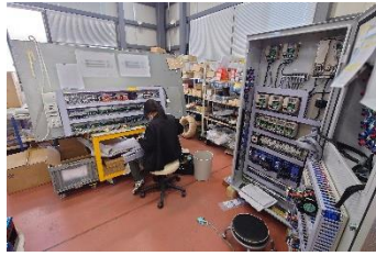
制御盤内部の製作並びに 製造中の制御盤
