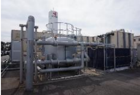
住吉工場のマンガン除去システム
