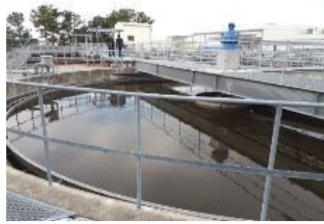
住吉工場の汚水処理施設
