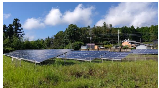
富士市大淵の太陽光発電設備
